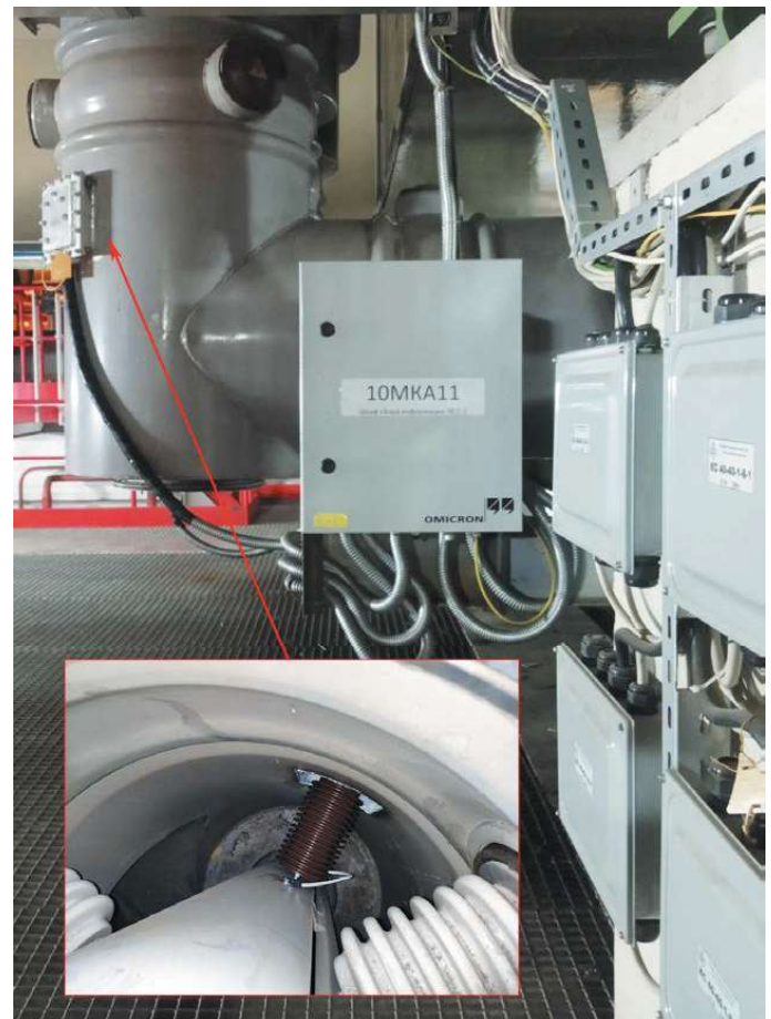
Рис. 18. Установка конденсаторов связи и шкафа устройства сбора данных СМ ЧР Северо-Западной ТЭЦ
